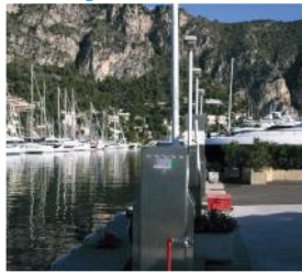
Station d'avitaillement Fuelling station
